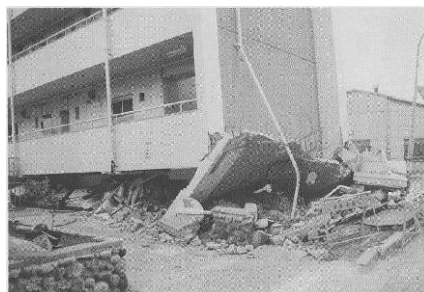
1 階のピロティ部分のみが完全に層崩壊しています。
