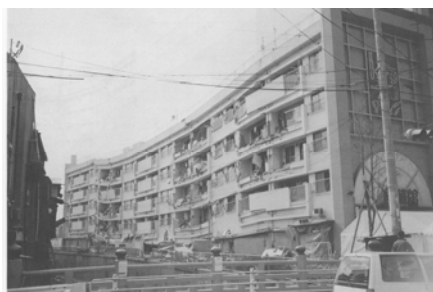
細長い建物で、1 階の中央部分の柱がせん断破壊して層崩壊 注2 を起こしています。
