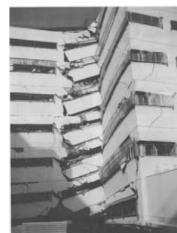
コの字型の住棟で一部分の圧壊がそれ以外の範囲まで被害を拡大しています。
